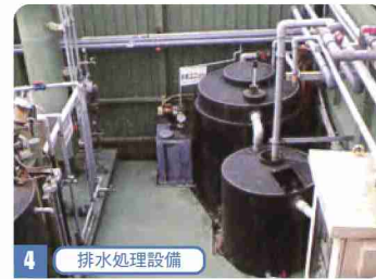
4 排水処理設備
